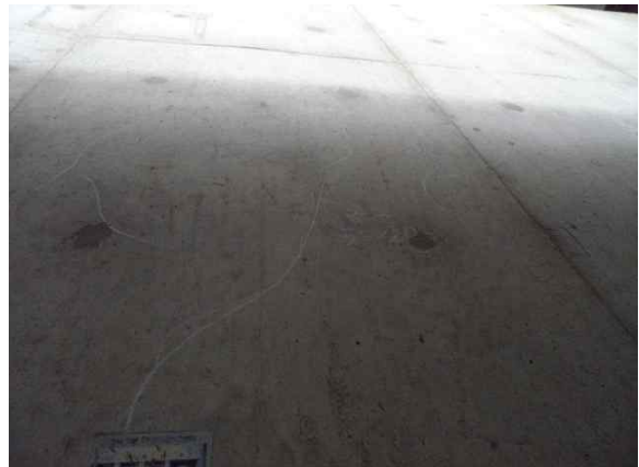
P1 코핑부 균열(폭 0.2mm)
