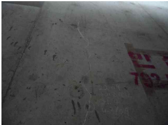
P1 코핑부 균열(폭 0.2mm)
